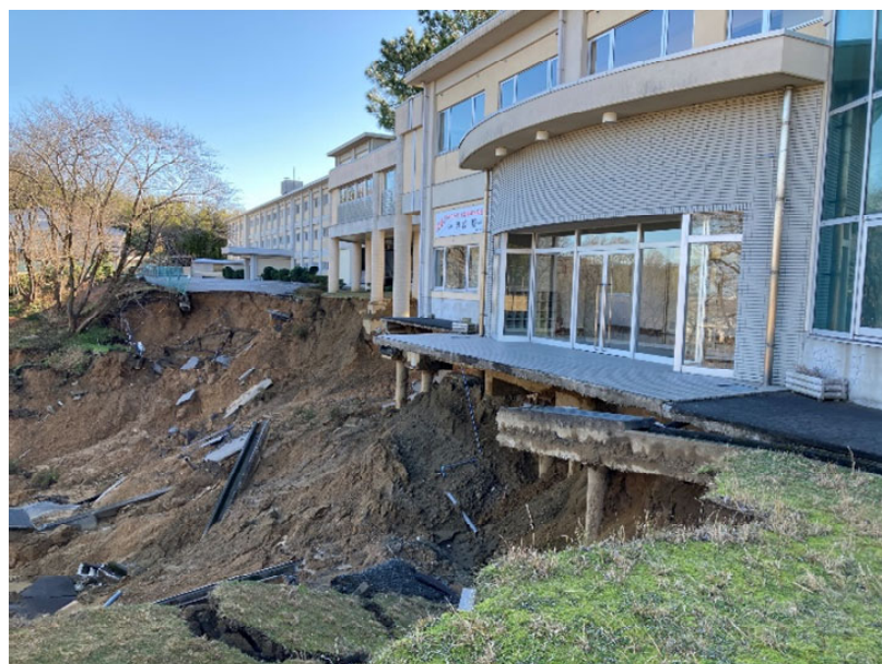
校舎前地盤が崩れ、地中杭が露出
