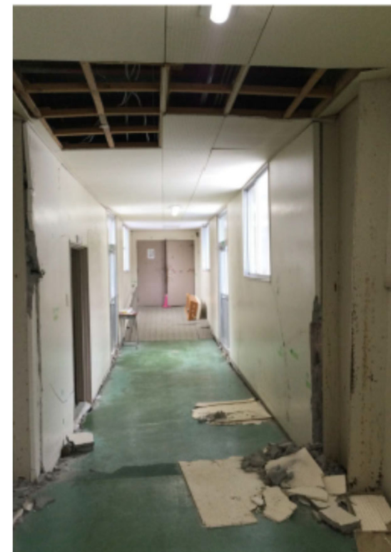
天井、内壁の落下
